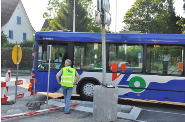
Hanspeter Bigler von den VZO im Einsatz auf der Baustelle beim Spital Uster.
